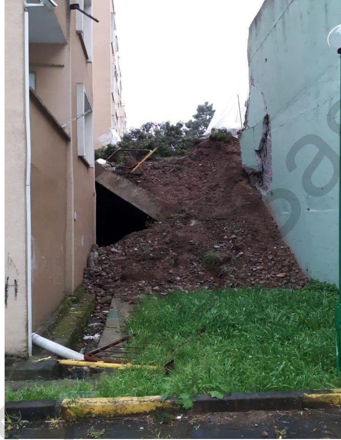
Şekil 3.18. Çöken istinat duvarı ve heyelan (ya da kütle hareketi.)
