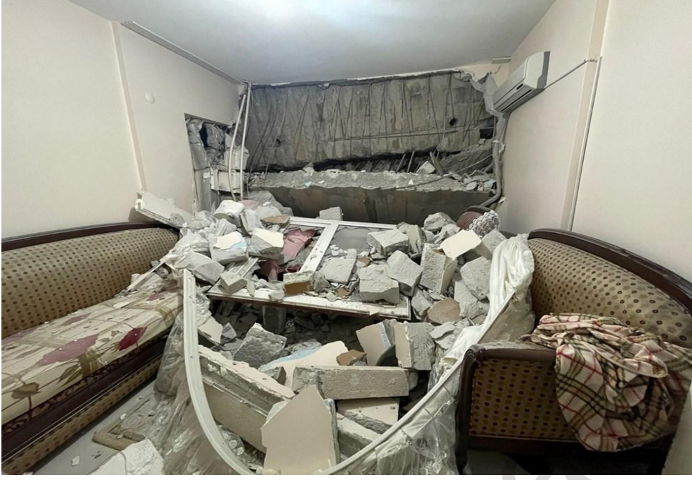
Şekil 3.19. Heyelan nedeniyle duvarı çöken bir oda.
