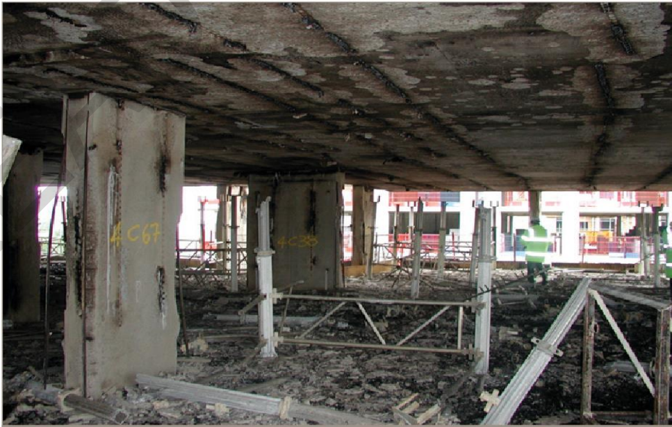
Şekil 4.10. Yangının hasar verdiği beton yapının içten görünümü.
